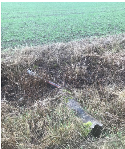
Befintlig trasig trumma vid Harbyvägen mot Borgby 1:1.
