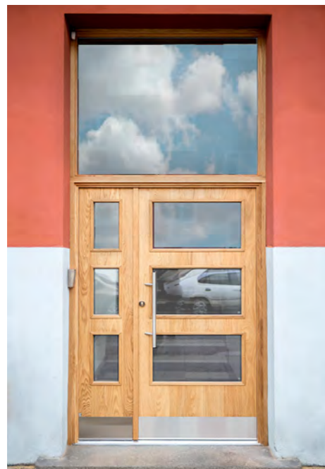
Hög sockel i puts - kulör som avviker från övrig fasad (Ref: Ekstrands Fönster och Dörr)
